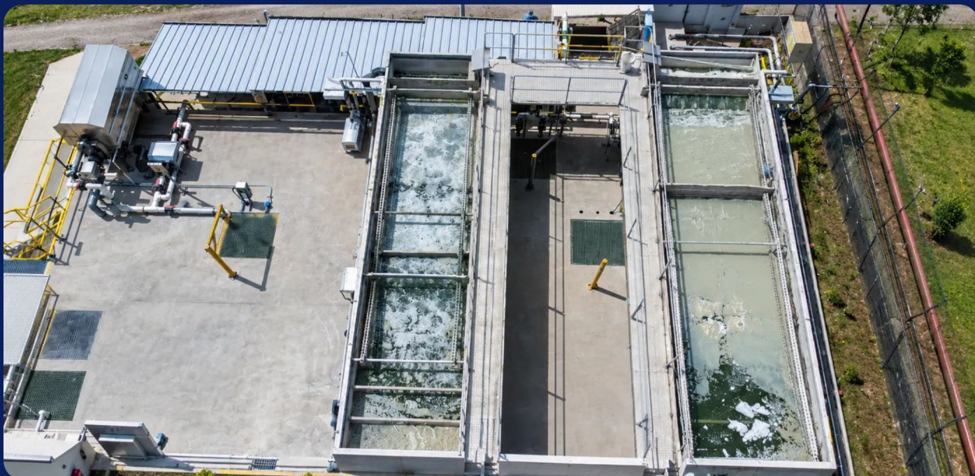
PTAR industrial de Danec · 1.200 m 3 /día
