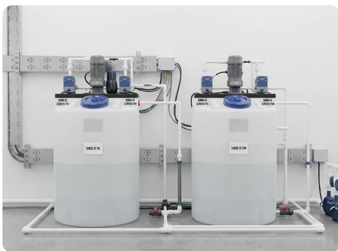
Equipo de preparación y dosificación instalado por AWT
