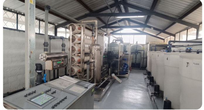
Sala de filtros y ósmosis inversa instalada por AWT
