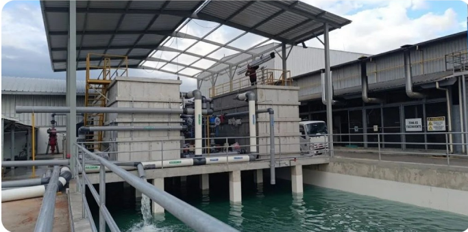
Planta de agua potable de Provefrut
