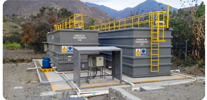
Planta compacta en Quinara, Loja
